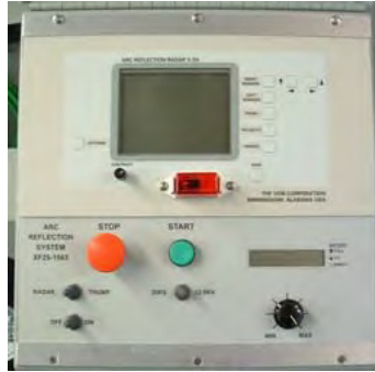
Detalle del panel de control
